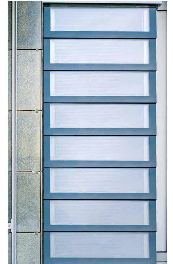
Das Lamellenfenster mit Funktion einer NRW-Anlage öffnet im Brandfall automatisch.
