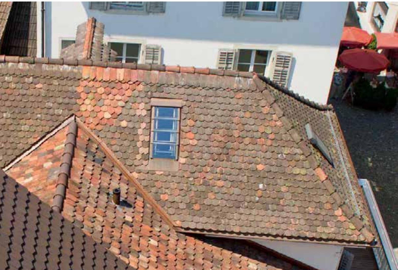
In der Zofinger Altstadt-Liegenschaft sorgen die beiden Dachfenster s:201 für Licht in luftigen Höhen. Dans cette propriété de la vieille ville de Zofingue, les deux fenêtres de toit s:201 créent une luminosité sublime.
